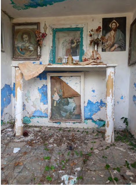
Il vano è completamente andato in malora.
